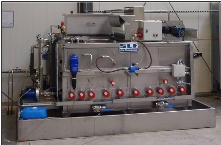
Anlagenbeispiel: Prozesswasserkreislaufanlage mit elektr. Badheizung, Plattenphasentrenner (Ölabscheider), Bandfilter und WHG-Auffangwanne
